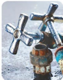
Fig. 4.44. En los baños y cocinas, igual que en las regiones muy húmedas, la corrosión de las piezas metálicas es difícil de evitar.
